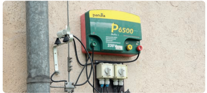
Weidezaungerät mit Hochspannungskabeln und Blitzschutzanlage.
